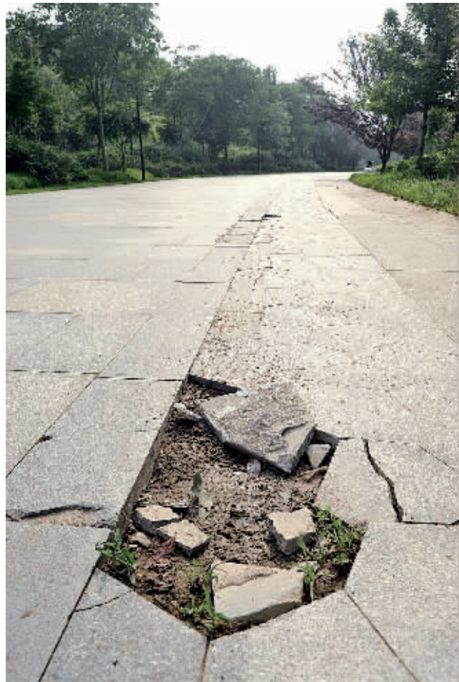
南山西入口的路面损坏挺严重
