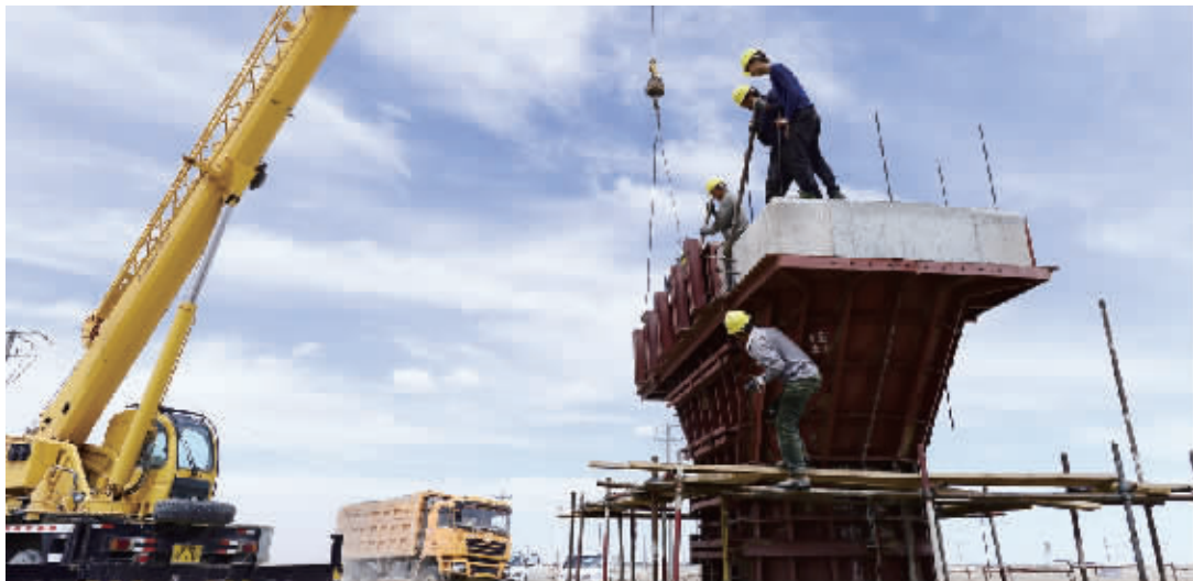
总投资376.41亿元的格尔木至库尔勒铁路于2014年底开工建设，目前来自中铁五局近千名建设者全力奋战在青海省格尔木市的茫茫戈壁中，不畏酷暑风沙加紧施工。据了解，格库铁路全长1213.7公里，其中青海境内505.6公里，新疆境内708.1公里，建设工期为5年。格库铁路的建成将进一步完善中国西部的区域路网布局，有效推动青海融入“丝绸之路经济带”。 新华社发
