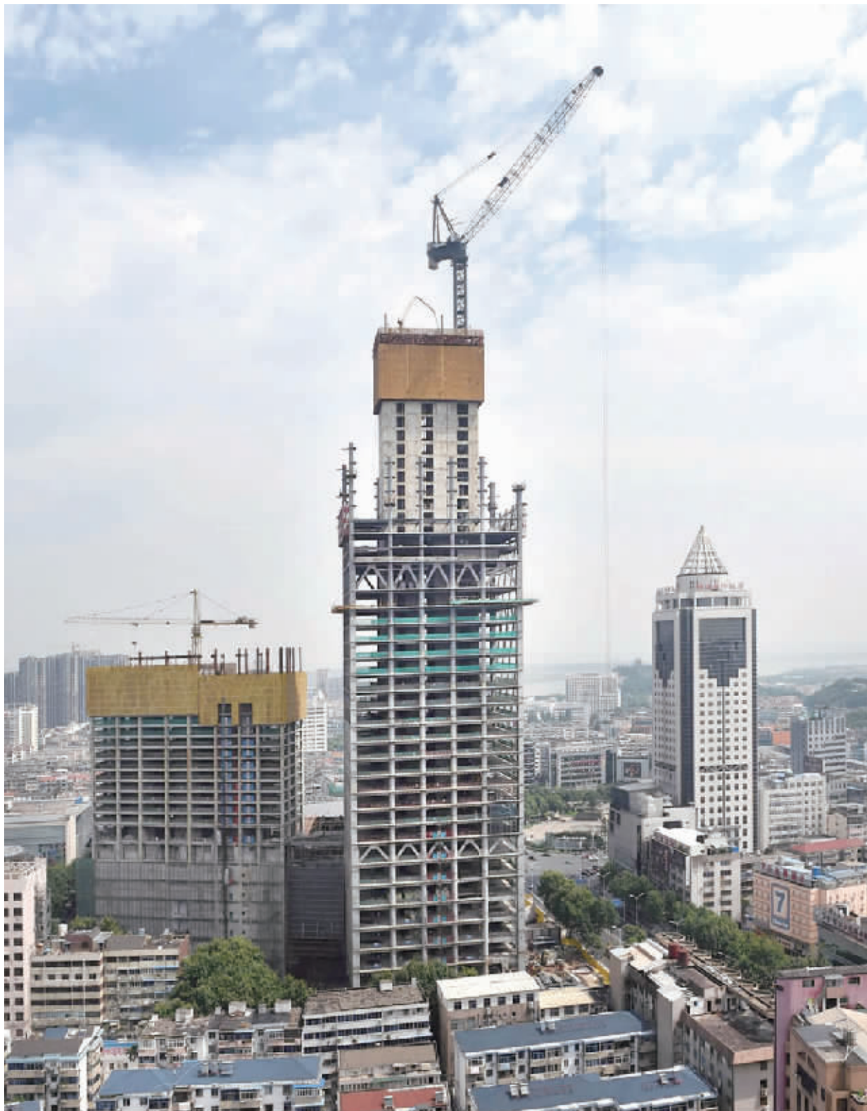
昨日,镇江市区出现湛蓝的“水晶天”。记者登上高处拍下了正在快速推高的镇江地标性建筑——苏宁广场。据负责施工的中建三局负责人介绍,目前苏宁广场东塔楼已推高到38层165米。
