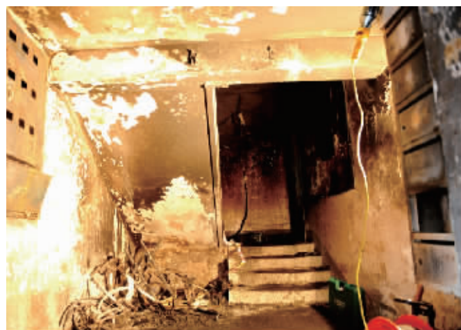
图为事故现场(6月25日摄)。 新华社发
